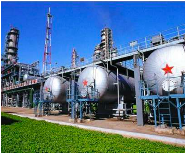
石油化工电子巡检 高配网、热风炉、 配碱车间...
